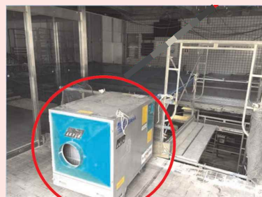
集塵機を設置し室内の換気を実施
