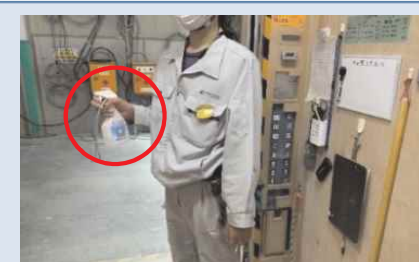
EVの操作盤等の消毒を徹底
