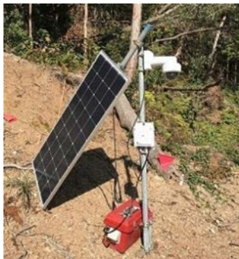
図-7 クラウド型カメラ設置状況
