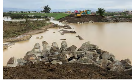
復旧工事開始直後の千曲川氾濫の様子
