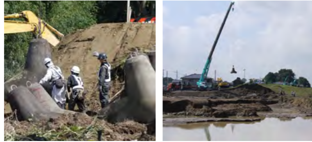
茨城県常総市での鬼怒川堤防での応急復旧工事 (写真提供:日刊建設通信新聞社)
