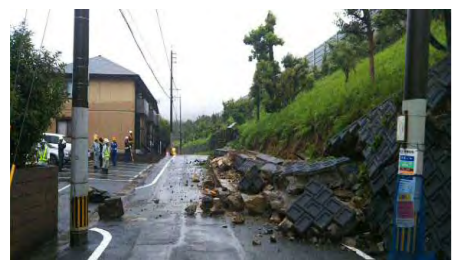
北九州自動車道 街道下の道路の決壊の様子
