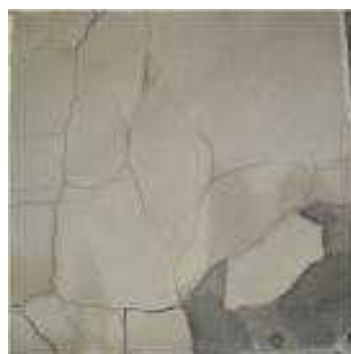
状態 : 金網より表層のみの剥落
