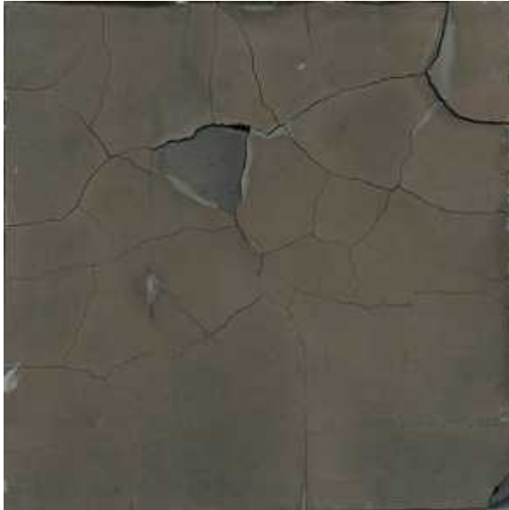
写真 - 3.2.5 耐火試験後の状況(No.3)[P7] (耐火試験後の損傷状態... : ひび割れ)
