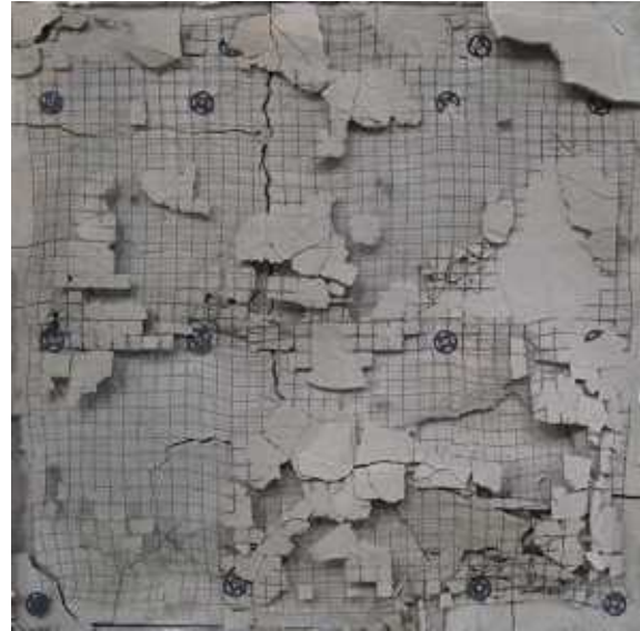
写真 - 3.2.10 耐火試験後の状況 (No.9)[V1] (耐火試験後の損傷状態... : 全面的な内部の爆裂)
