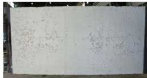
写真1 No.1(無補修)実験後の状況
