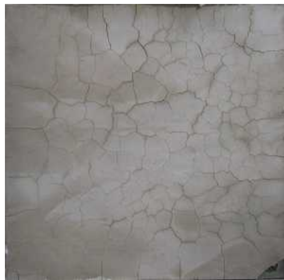
写真 - 3.2.12 耐火試験後の状況 (No.10)[E3-B] (耐火試験後の損傷状態... : ひび割れ)
