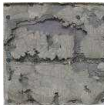
状態 : 全面的な内部の爆裂
