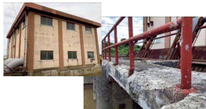
写真・2 現排水機場劣化状況
