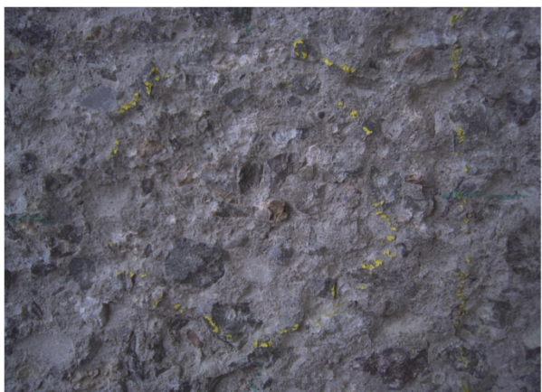
はつり面拡大写真
