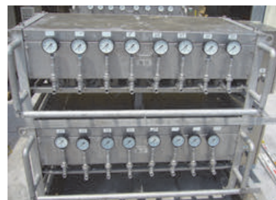
写真-2 流量・圧力検出器ユニット
