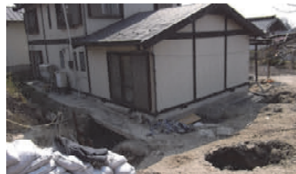
写真-2 東北地方太平洋沖地震による 亜炭廃坑の被害(宮城県栗原市、2011年3月)
