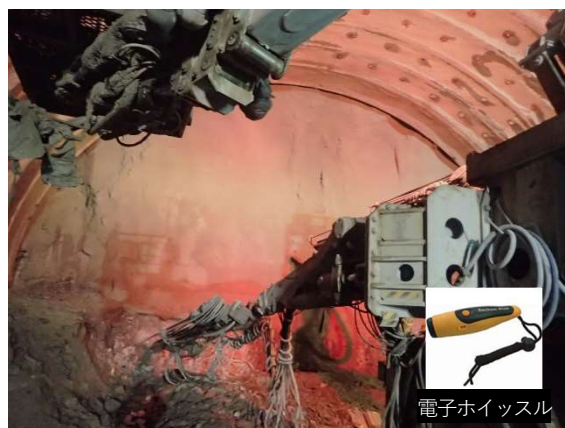
写真3 肌落ち危険時警告装置 (赤色 LED)
