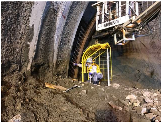
写真 11 マンゲージによる落石防護 (防護柵付き)
