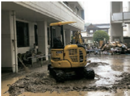
大雨による災害被災地の復旧・支援
