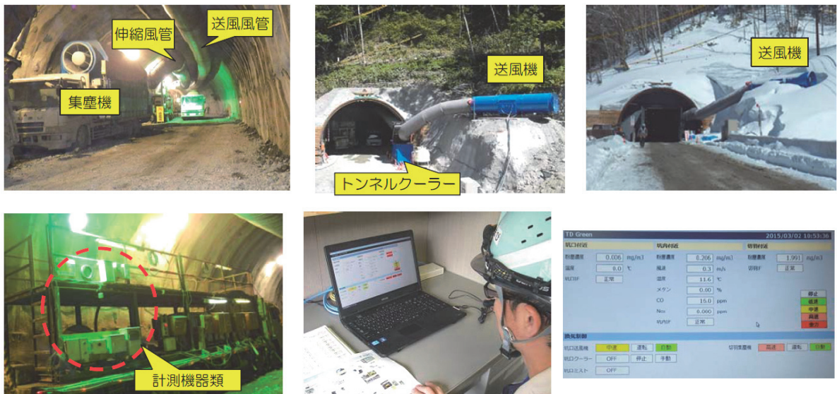
写真-1 システム稼働状況
