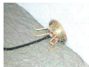
写真-2 充填材検知センサの設置状況
