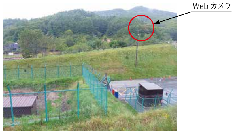
監視カメラ設置の例
