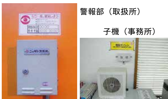
自動警報装置の設置の例
