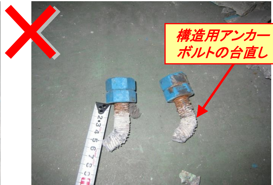
破断部分の拡大写真
