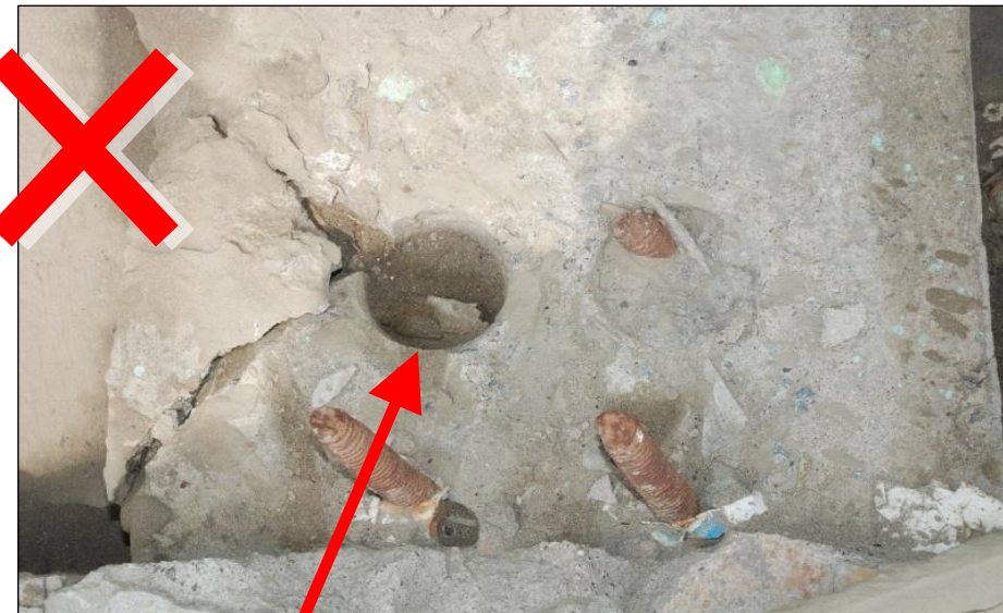
破断部分の状況
