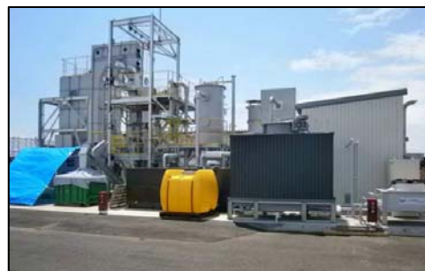
写真-6 木質バイオマスガス化発電
