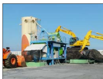
主灰固化プラント
