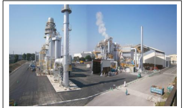
写真-6 稼働中の焼却炉
