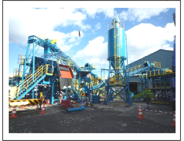
写真-9 主灰造粒固化設備
