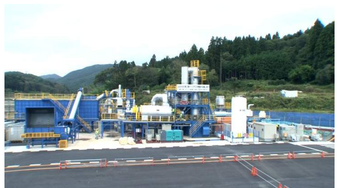
写真-14 木質バイオマス発電施設
