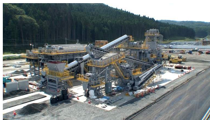
写真-15 土壌洗浄施設
