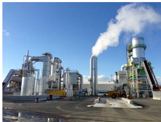
写真-6 稼働中の焼却炉（階上地区）
