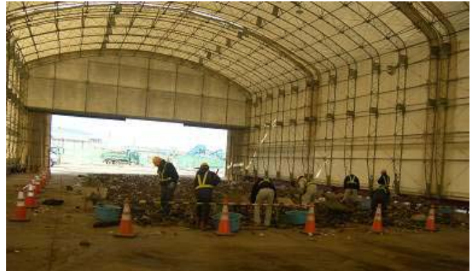
写真-11 屋内選別設備
