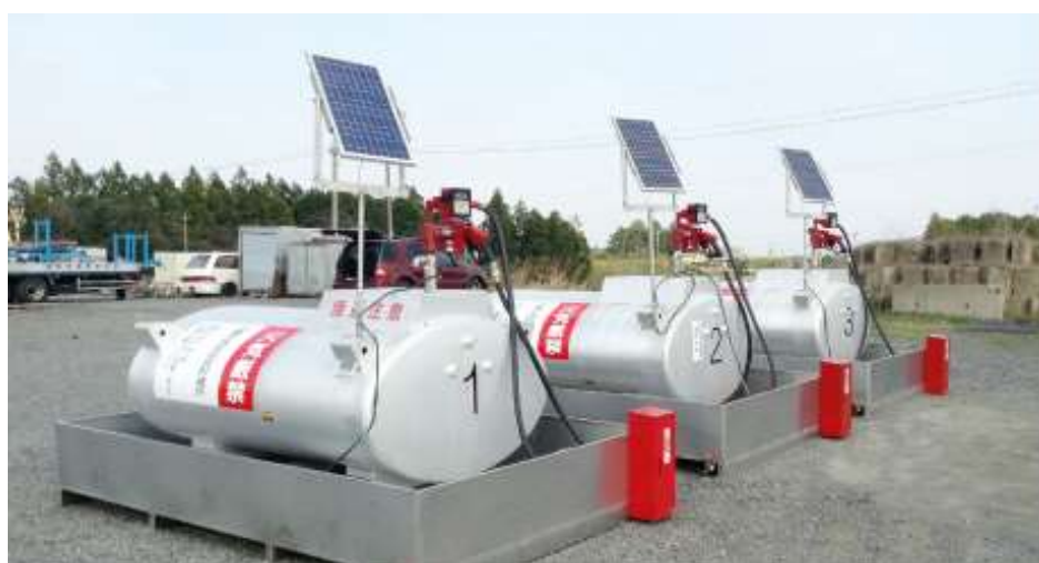
写真2-1 一体型のタンクの設置事例
