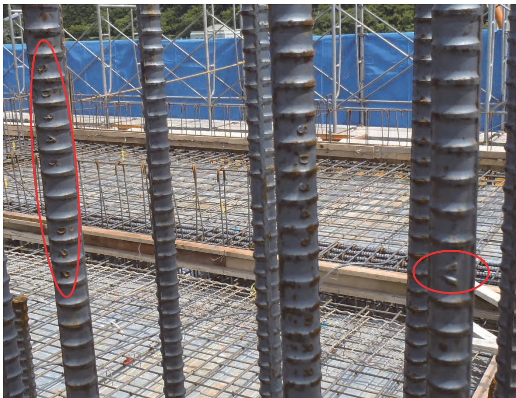
写真 4.2.2.2. 大谷製鉄㈱のロールマーク
