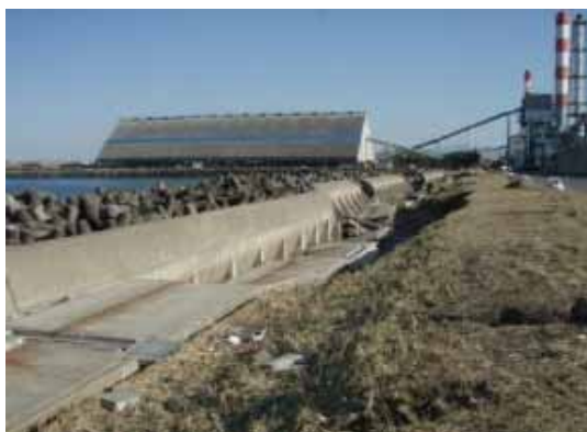
図 5.5.4 押し波による護岸の被災事例 52)
