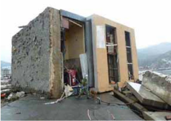
図 5.5.51 直接基礎建築の転倒 58) (女川町、3階建) 浸水深 15m 程度
