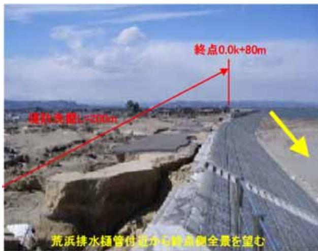
図 5.5.30 荒浜地区堤防被災状況 55)
