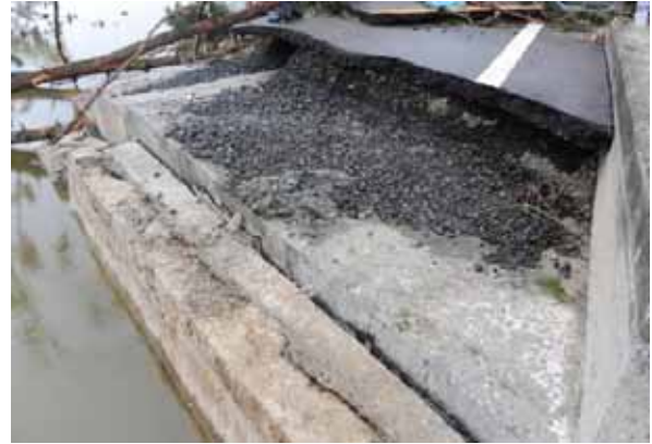
図 5.5.48 ボックスカルバートの上面 57)
