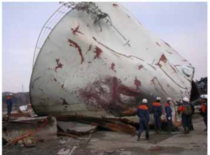
図 5.5.65 タンク本体の被害状況 62)
