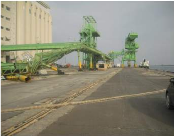
図 5.5.10 荷役機械の被災事例 52)
