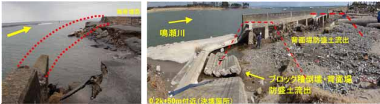
図 5.5.28 野蒜地区堤防被災状況 55)
