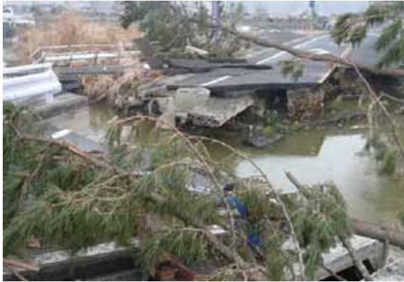
図 5.5.47 流失した裏込土部分 57)
