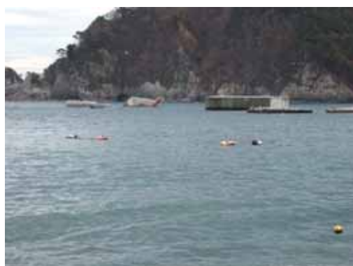
図 5.5.69 防波堤の被災状況 65)
