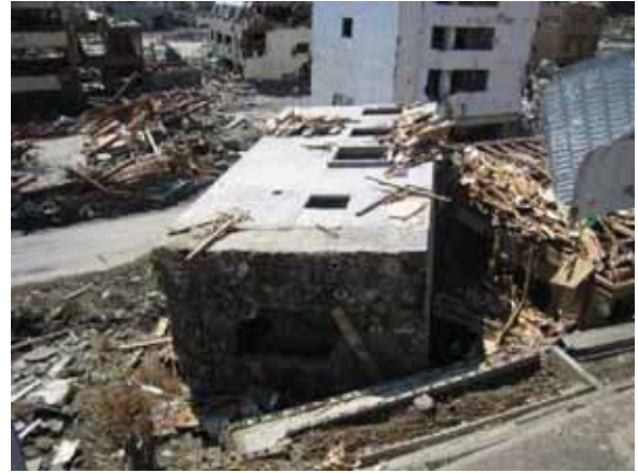
図 5.5.52 杭基礎建築の転倒 58) (女川町、4階建) 浸水深 14.6m
