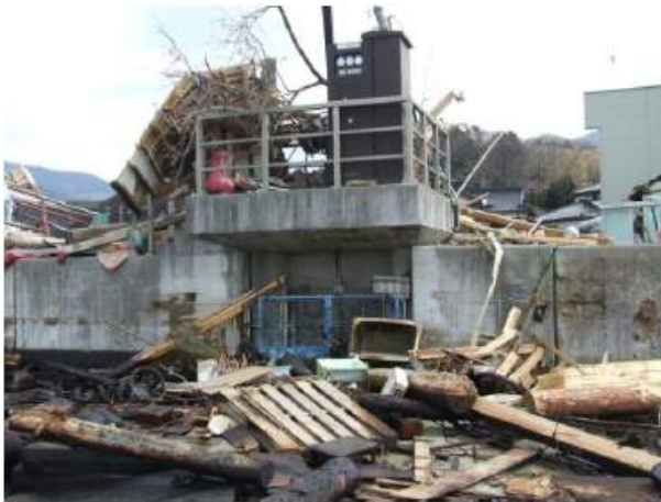
図 5.5.12 電気設備の被災事例 52)
