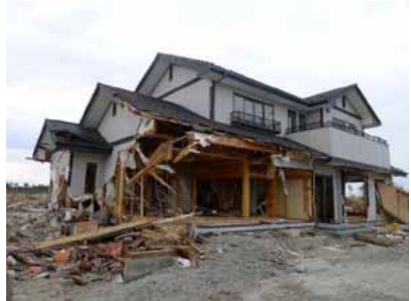
図 5.5.60 建物隅部の流失 58) (山元町、2階建) 浸水深 2~4m 程度
