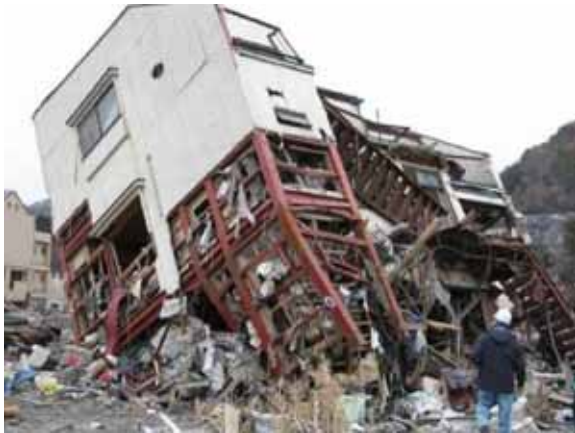
図 5.5.55 1階の崩壊 58) (大槌町、3階建) 浸水深 7.3m
