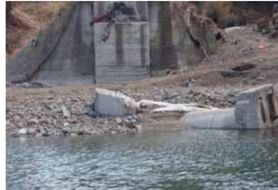
図 5.5.45 倒壊した単柱式 R C 橋脚 57)
