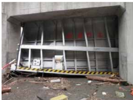
図 5.5.8 押し波による陸閘の被災事例 52)
