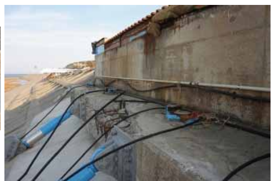
図 5.5.39 橋台部の破壊状況 57)
