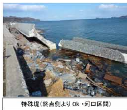
図 5.5.25 月浜堤防(特殊堤部)被災状況 55)
