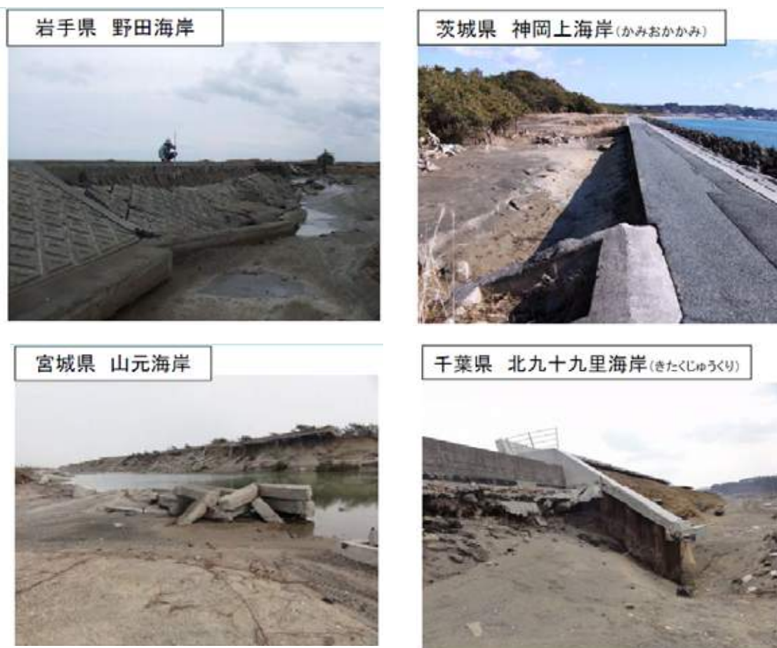
図 5.5.86 被災事例①-1~4 68)
