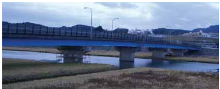
図 5.5.36 地震前の小泉大橋 57)
