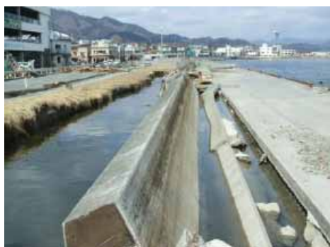
図 5.5.6 押し波による防潮堤の被災事例 52)
