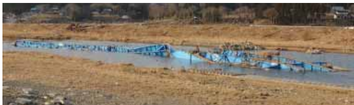
図 5.5.38 流出した橋桁 57)
