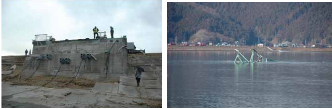
図 5.5.35 破壊された橋台及び流出したトラス 57)
