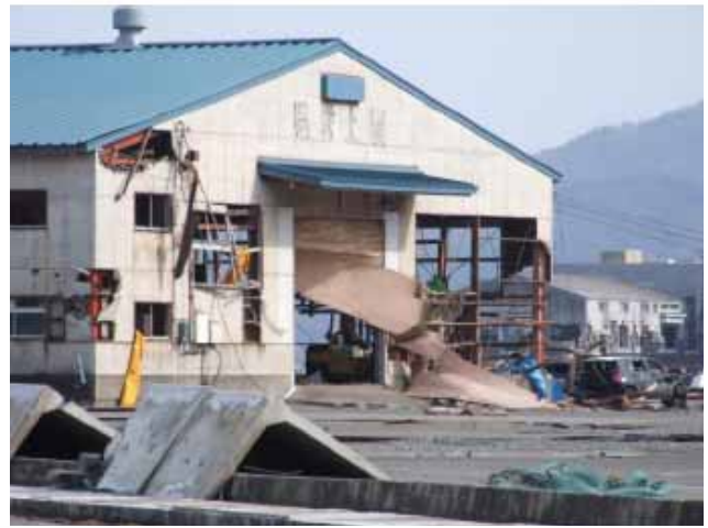
図 5.5.11 上屋の被災事例 52)
