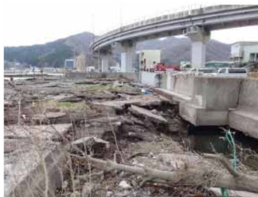
図 5.5.5 引き波による護岸の被災事例 52)
