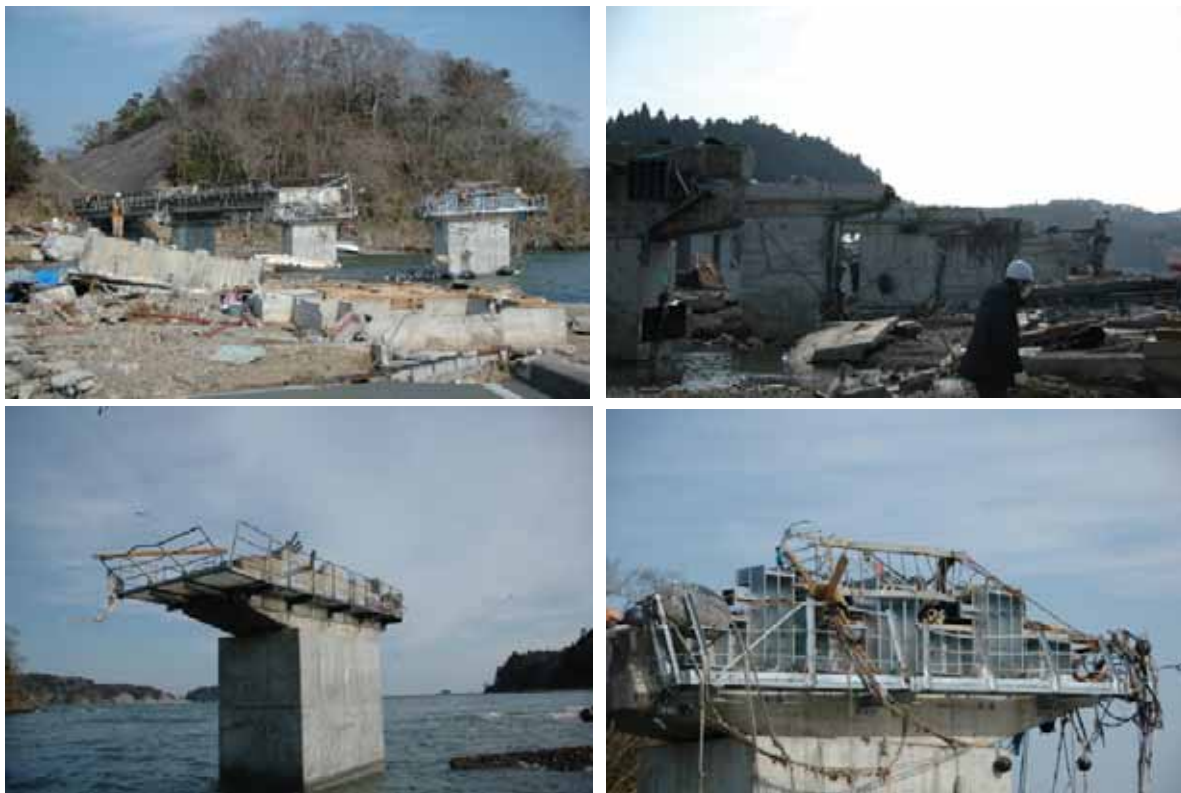
図 5. 5. 40 歌津大橋の橋脚と落下した P C T 桁 57)
