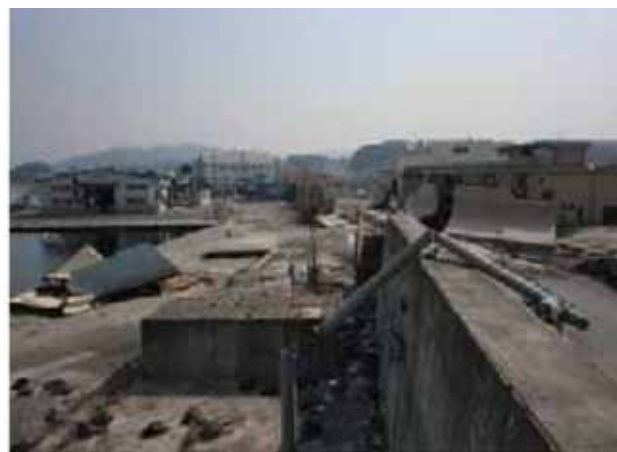
図 5.5.74 防潮堤の被災状況 65)
