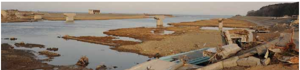
図 5.5.37 小泉大橋の被害状況 (橋脚) 57)
