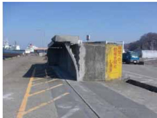
図 5.5.9 引き波による陸閘の被災事例 52)
