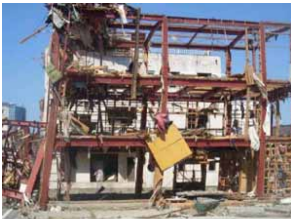
図 5.5.57 傾斜および外壁消失 58) (女川町、3階建) 浸水深 15m
