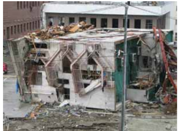
図 5.5.56 転倒 58) (女川町、3階建) 浸水深 15m 程度
