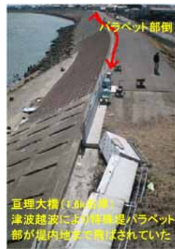
図 5.5.31 荒浜地区堤防被災状況 55)
