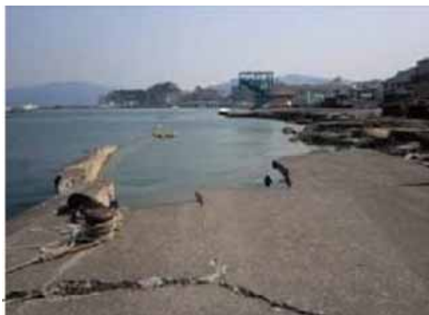
図 5.5.73 岸壁の被災状況 65)
