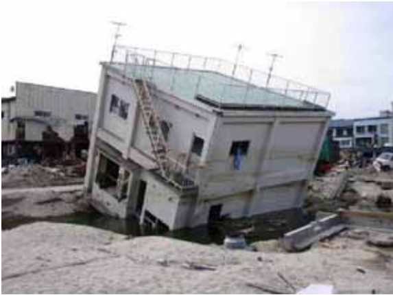
図 5.5.53 基礎洗堀による傾斜 58) (山田町、2階建) 浸水深 6.2m
