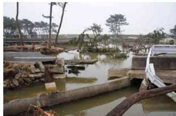
図 5.5.46 葦森橋の被害状況 57) (ボックスカルバート形式)
