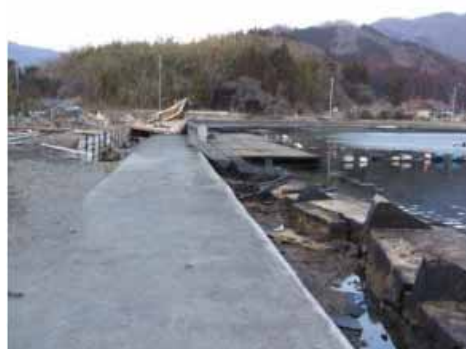
図 5.5.7 引き波による防潮堤の被災事例 52)
