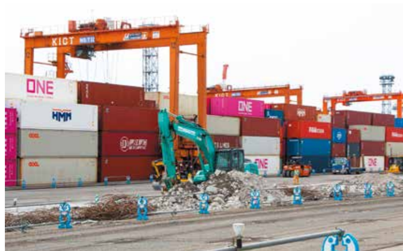
休むことなく稼働するバース内では路盤・路床の補強や設備の更新なども頻繁に行われる。荷役機械・車両の動線や荷役作業への影響を最小限に抑えるため、綿密な打合せと工程確認は必須だ。施工者にも経験値に裏付けられた繊細な施工管理が求められる
