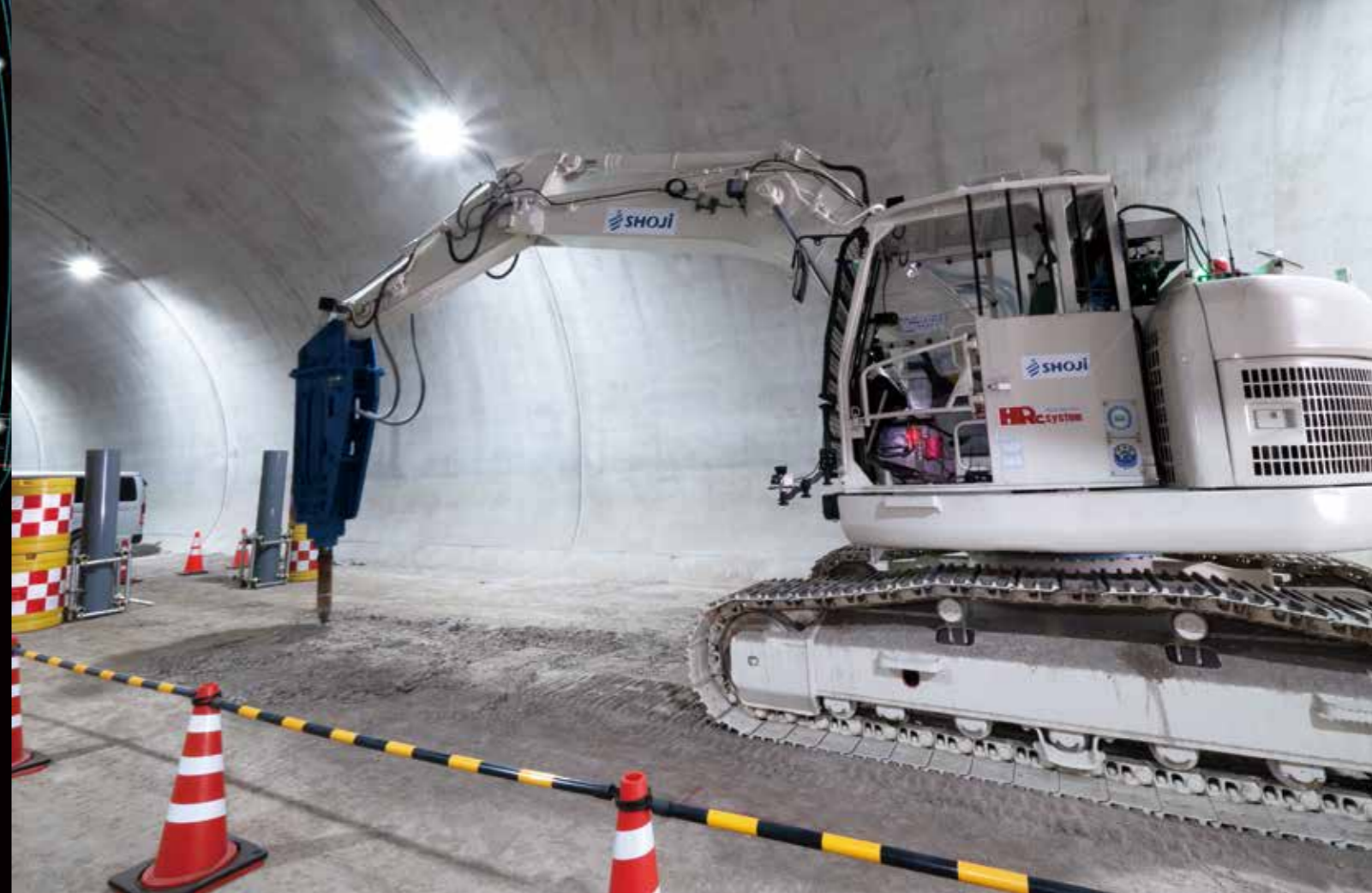
ICTを搭載した大型ブレーカーによるインバート掘削。デジタルツインのデータを用いて自動化されており、オペレータは不在。
