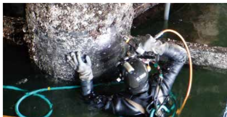
鋼管のケレンなど、大部分は潜水作業となる。(画像提供:あおみ建設株)
