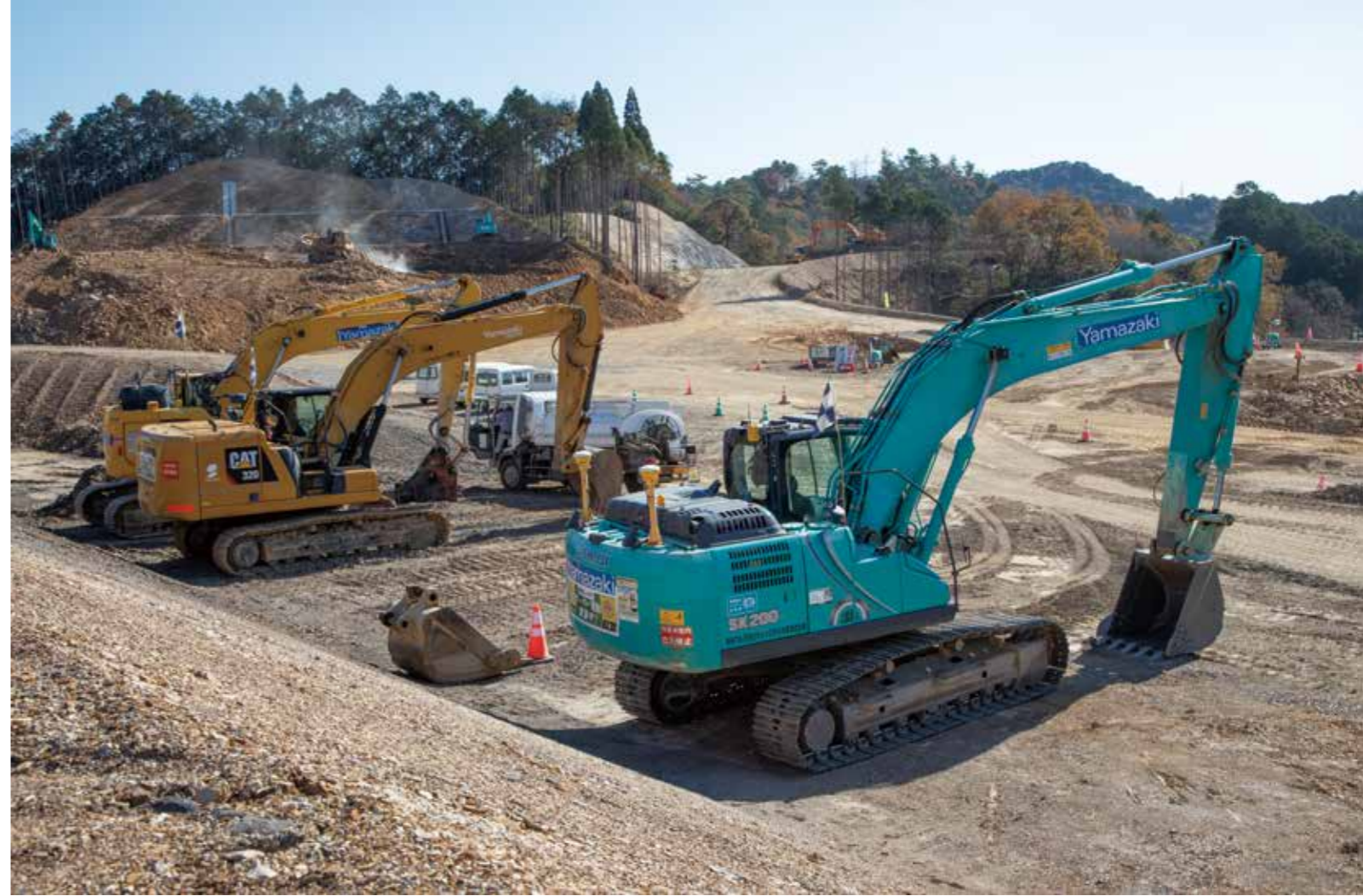
手前にはICTを搭載した建機が見える。「導入のきっかけは、北海道厚岸町での太陽光発電所の現場で便利さを痛感したことです」(嶋崎所長)
