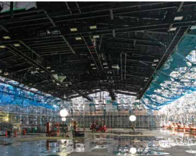
上／横浜武道館、2階アリーナ天井部分の施工イメージ図。2階床面をヤードとして地組みし、完成後にリフトアップして施工した。 下／リフトアップ後の天井部分の様子。「工期は最短で安全も担保できる。こうした工夫をとことん議論して、最も適切な工法を採用しました」(和田氏) (いずれも提供：(株)フジタ)
