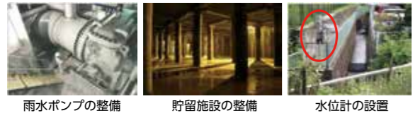
雨水ポンプの整備 貯留施設の整備 水位計の設置
