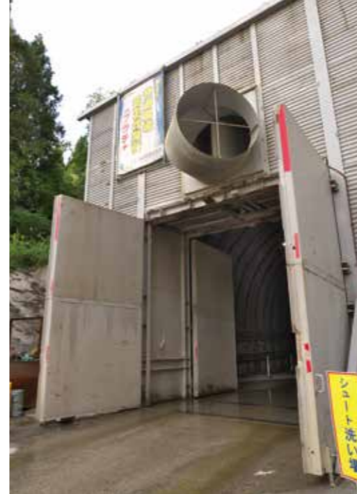
坑口には砂を充填した2mもの防音壁を設置し発破音を遮断した。
