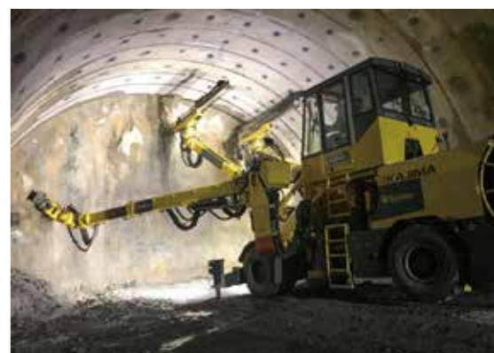
コンピュータジャンボによる穿孔状況。(提供: 鹿島建設株)
