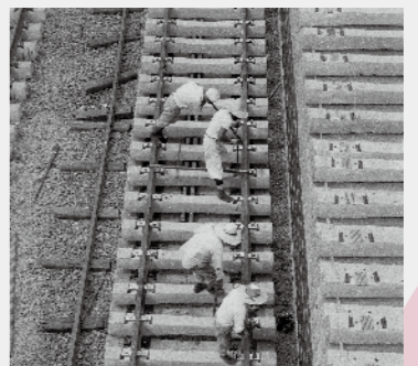
東海道新幹線の線路工事にて線路組立作業の様子(提供:鉄道博物館)
