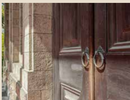
1935（昭和10）年に完成した旧桜宮公会堂の本体はSRC造だが、建物全体は鑄造所の当時の様子に復元され、鑄造所の正面玄関と共鳴する意匠が各所に施されている。明治から昭和へと、時を超えたデザインの調和が優美さを際立たせている。
