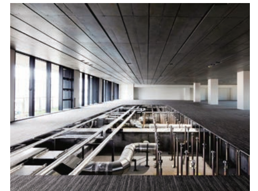
RC天井と床下空調という逆転
