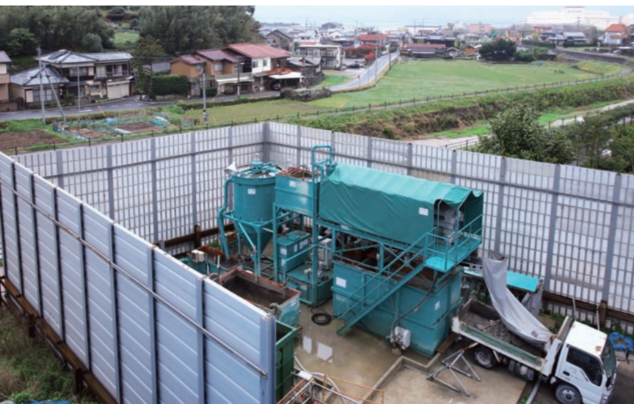
上/現場のすぐそばに市営住宅や戸建ての民家が建ち並ぶ。 下/濁水プラントや排出土ピット廻りにも防音壁を設置し、隙間にはパネルやシートを設置。粉塵や工事音の拡散を防いでいる。
