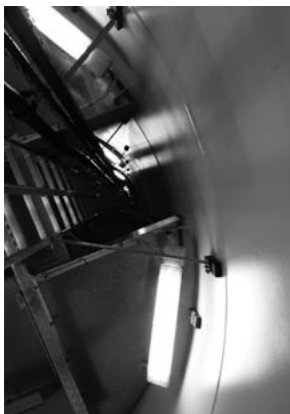
風力施設主塔内。
