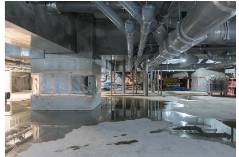
右/地上3階まで採用されている粘性体制振壁。 左/地上3階と4階の間にある免震層の様子。
