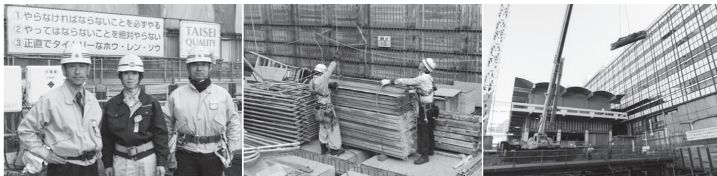
左/現場内にて、左から須藤所長、松沢、内馬場副所長。 中/型枠や足場の材料をまとめて吊り、移動させる。現場内では、人力で運べる物の方が少ない。 右/工事は昭和の名建築と言われる法政大学55・58年館の直近で行われており、操作にはよりいっそうの慎重さが求められる。
