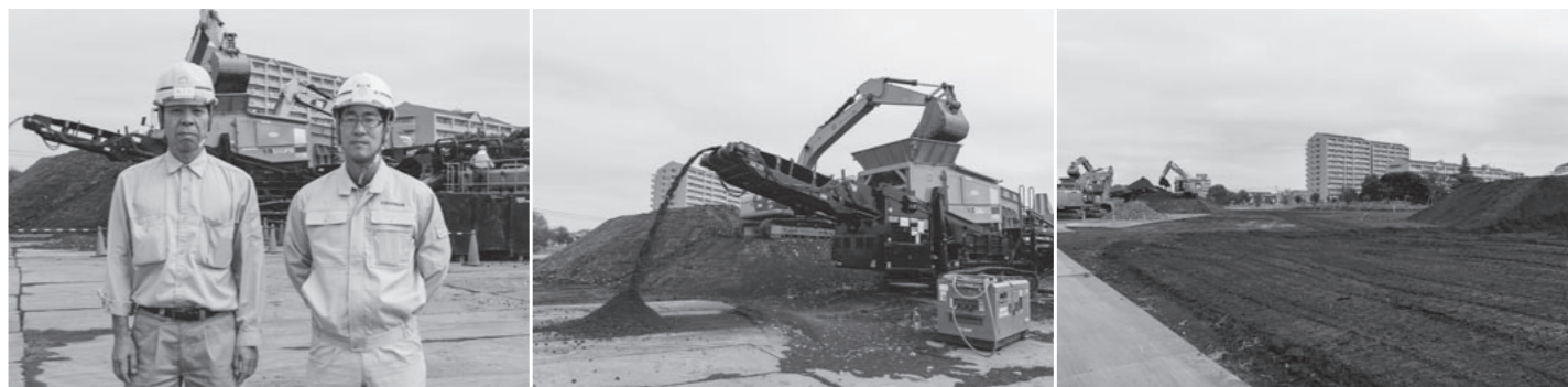
左／施工現場前にて、鴻池組・三倉靖所長、類瀬。 中／[道路をつくる前に先行して土を削って排水用の雨水管を入れる工事と、土壌を選別する工事を2カ所で同時に進めています] 右／現場では千葉ニュータウン21地区の開発が進行しており、完成すれば大規模な住宅地になる。
