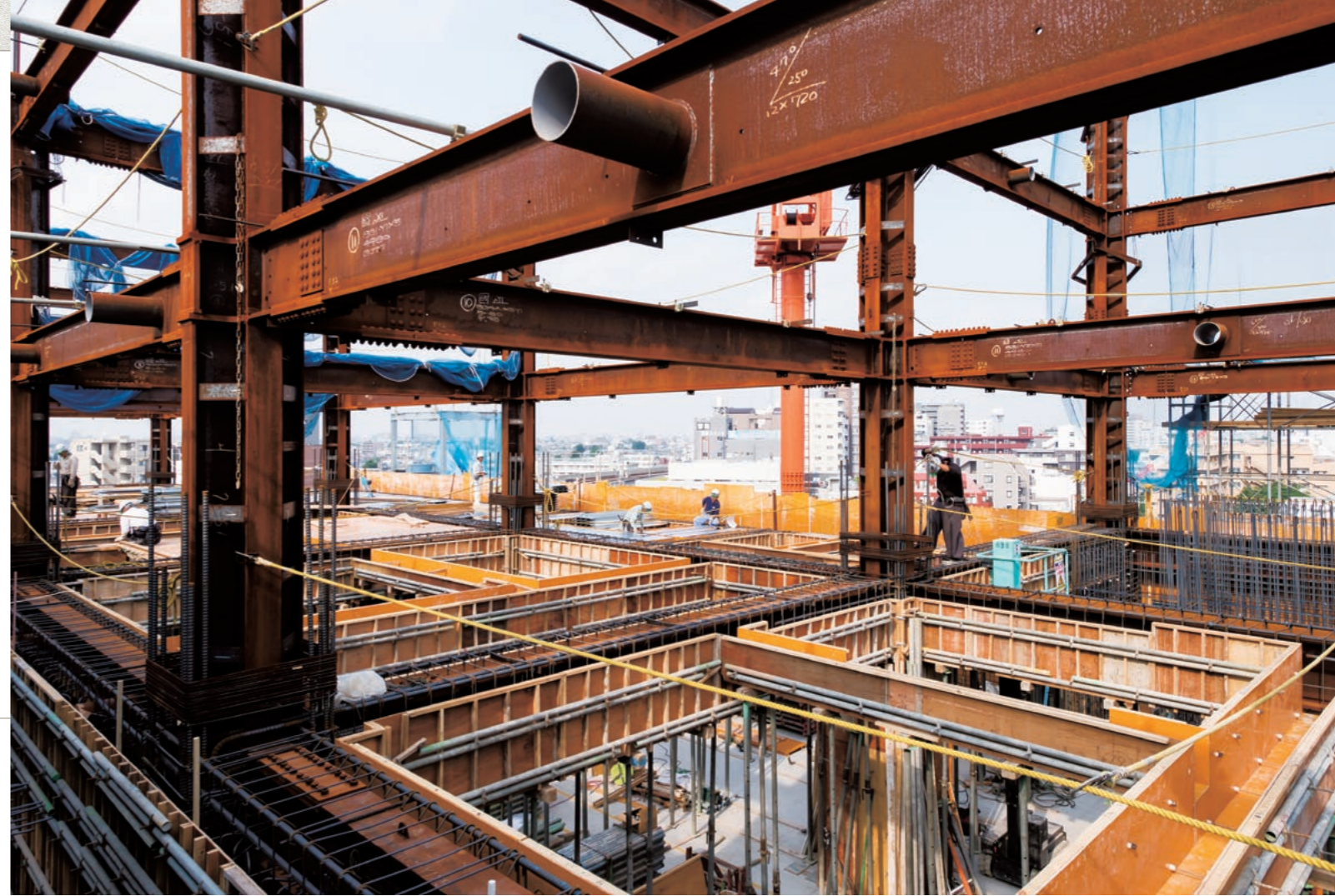
鉄骨造と言っても違和感はない、H型鋼800×250mmの2つを組み合わせた十字形の柱が鎮座する6階の作業風景。居住スペースとして計画されているフロア。まわりに大きな建物はなく、景色もバツクンだ。
