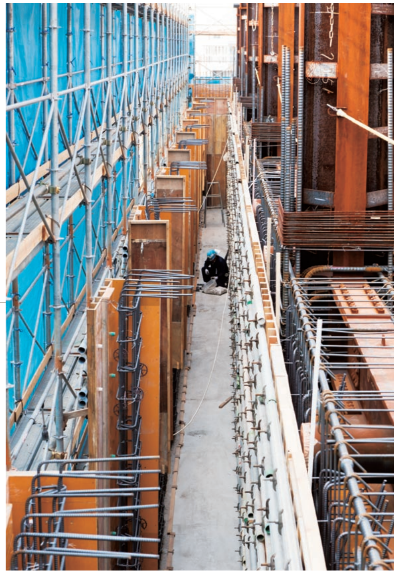
6階住居スペースのバルコニー部分建設風景。非常用侵入口も兼ねている。
