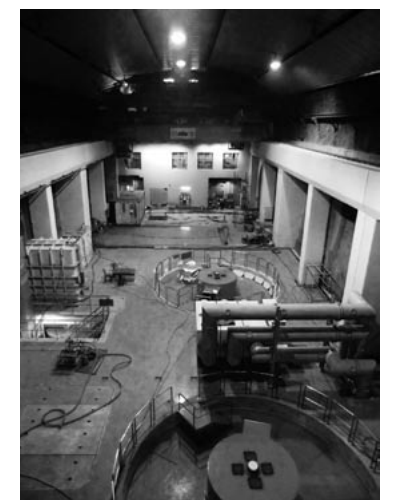
地下発電所内部
