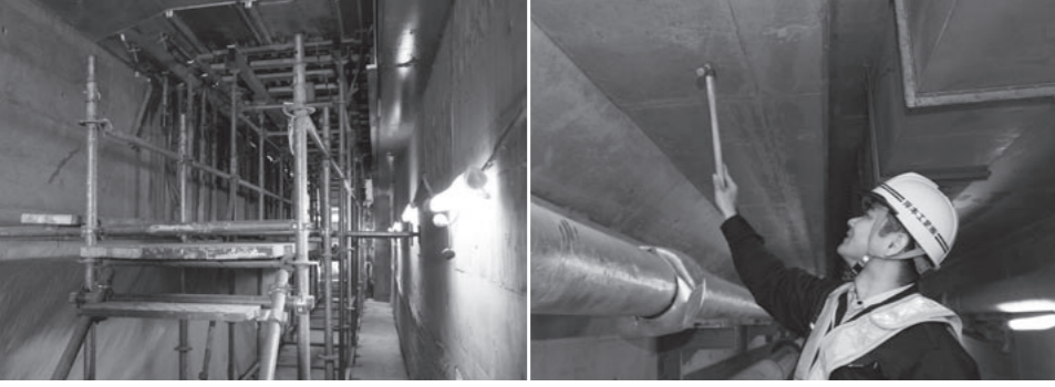
左/狭い空間に足場と支保工を組んで型枠を設置する。このような既存施設の耐震補強工事は、今後増えていくものと予想されている。 右/コンクリートの仕上がりをチェックする。 「脱型したコンクリートの表面を見て…きれいにできて光ってたら、やっぱりうれしいですね」
