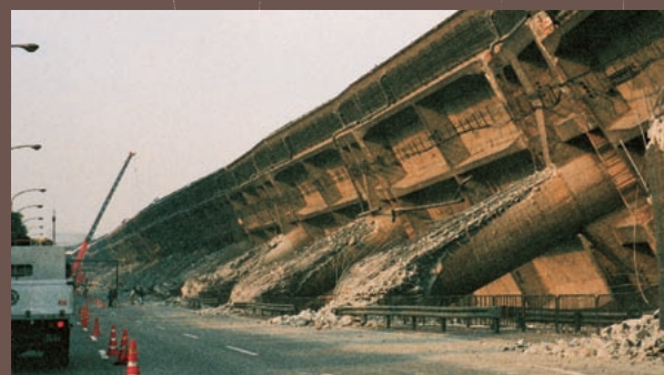
1995（平成7）年の阪神・淡路大震災で橋脚が破壊された阪神高速道路（提供：阪神高速道路株式会社）
