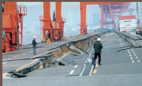
岸壁背後が大きく陥没したコンテナバース。コンテナを荷役するガントリークレーンも使えなくなった。(提供：国土交通省神戸港湾事務所)
