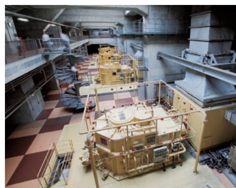
調圧水槽の水を江戸川へ排出する排水機場の4台の巨大ポンプ。4台で200m 3 /秒の排水能力を誇る。1秒間に25mプール一杯分の水を汲み上げる放水路の「心臓部」だ。
