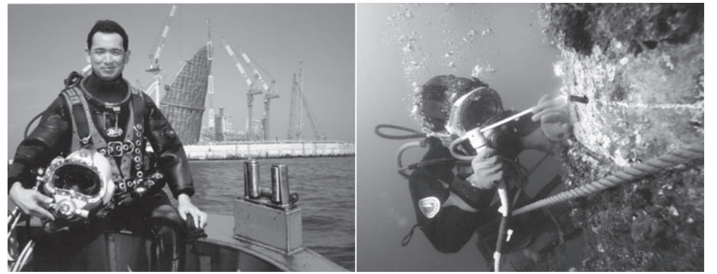
右/海中での溶接作業。陸上よりはるかに不安定な体勢、しかも通電をとまなうため、高度な技術と経験が不可欠。 左/東京湾アクアラインの換気施設「風の塔」の建設現場をバックに。このころから、作業潜水士の工事は複雑化の一途をたどった。
