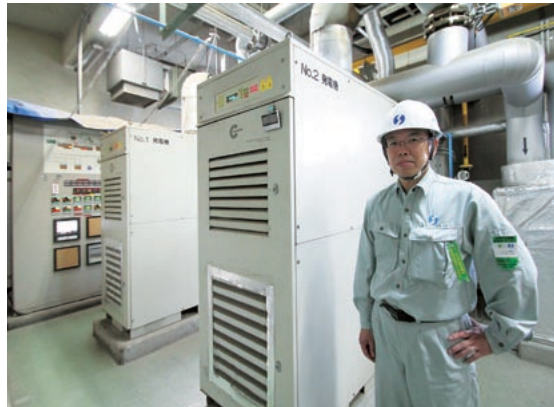
「処理工程で発生した消化ガス（メタン）をボイラ燃料として消化槽の加熱、発電に活用。省エネ化も進めています」と語る市川常務。
