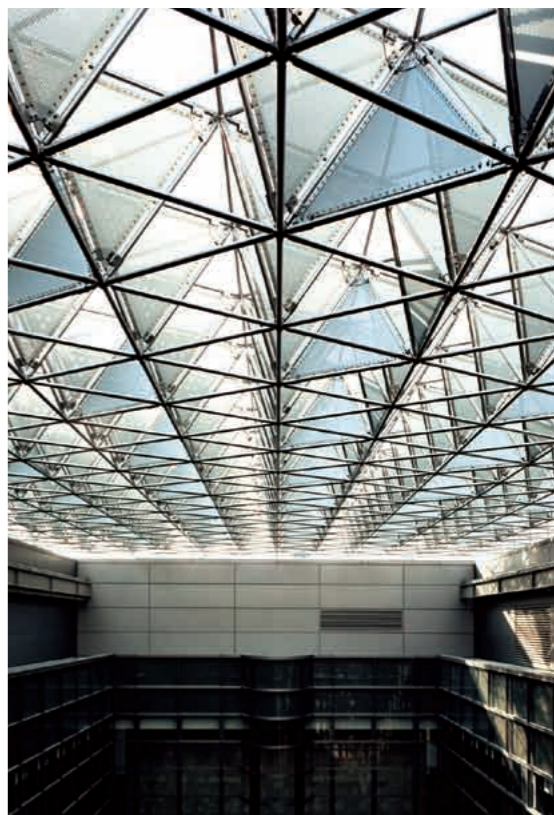
縦のつながりを実現した光庭の最上部に位置し、自然の光を最大限に採り入れ、西日や夏の日差しを遮光する立体トラス。
