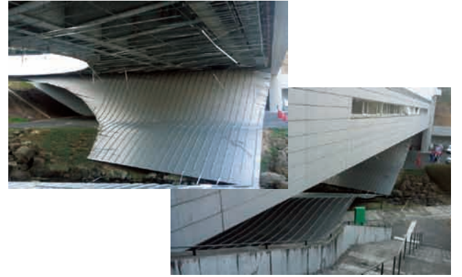
軒天井の被災状況
