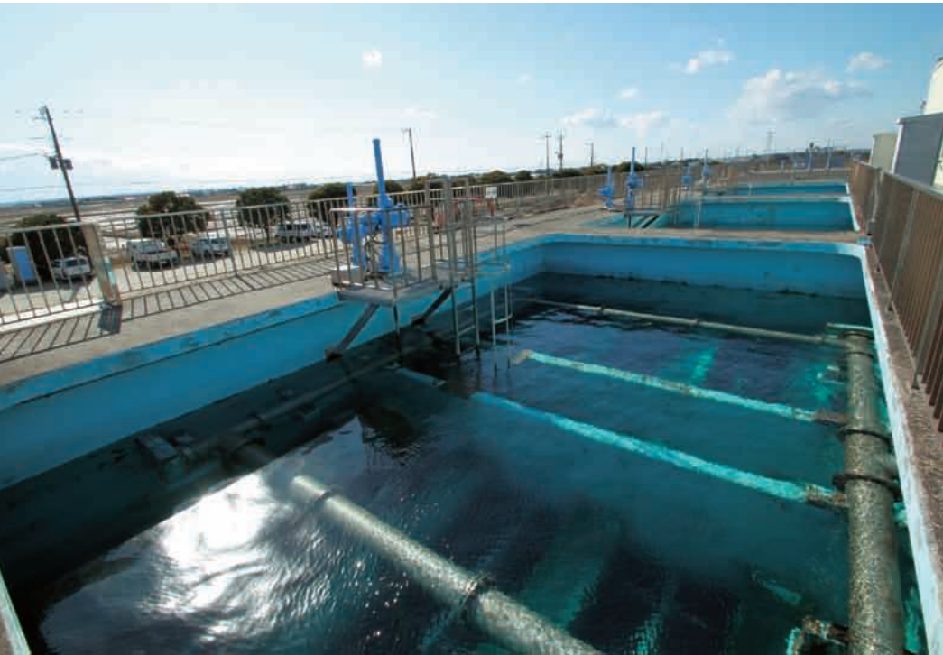
仮復旧から本復旧へ向かう鰐川浄水場 大林組の懸命な応急復旧工事により水で満ちた急速ろ過池。本復旧は先ではあるが、浄水場の役割を果たしている。(写真：中原一隆)
