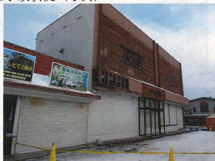
外壁落下後の建物写真①
