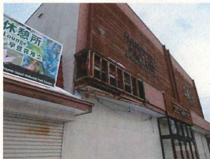
外壁落下後の建物写真②
