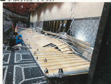
落下部分の全景
