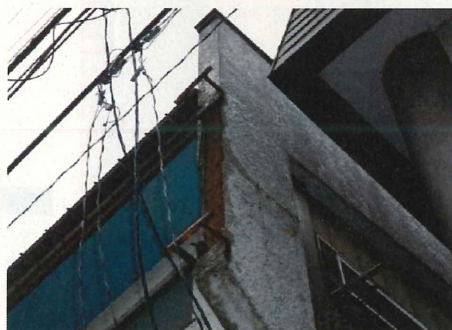
外壁剥離箇所
