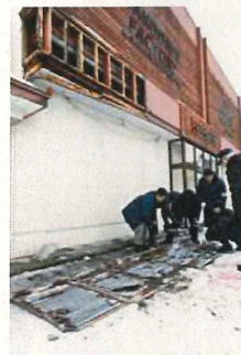
落下した外壁
