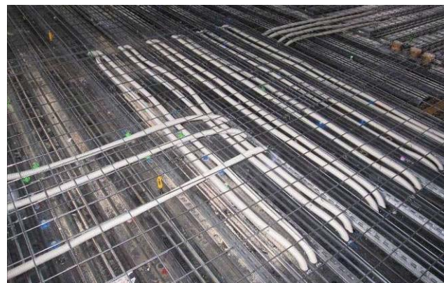
合成スラブデッキ電気配管不具合事例 (50Φと配管が太く、鉄筋、デッキと接している)
