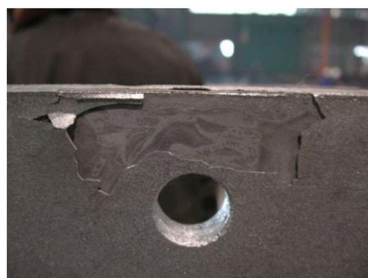
部材角部の めっき剥がれの例
